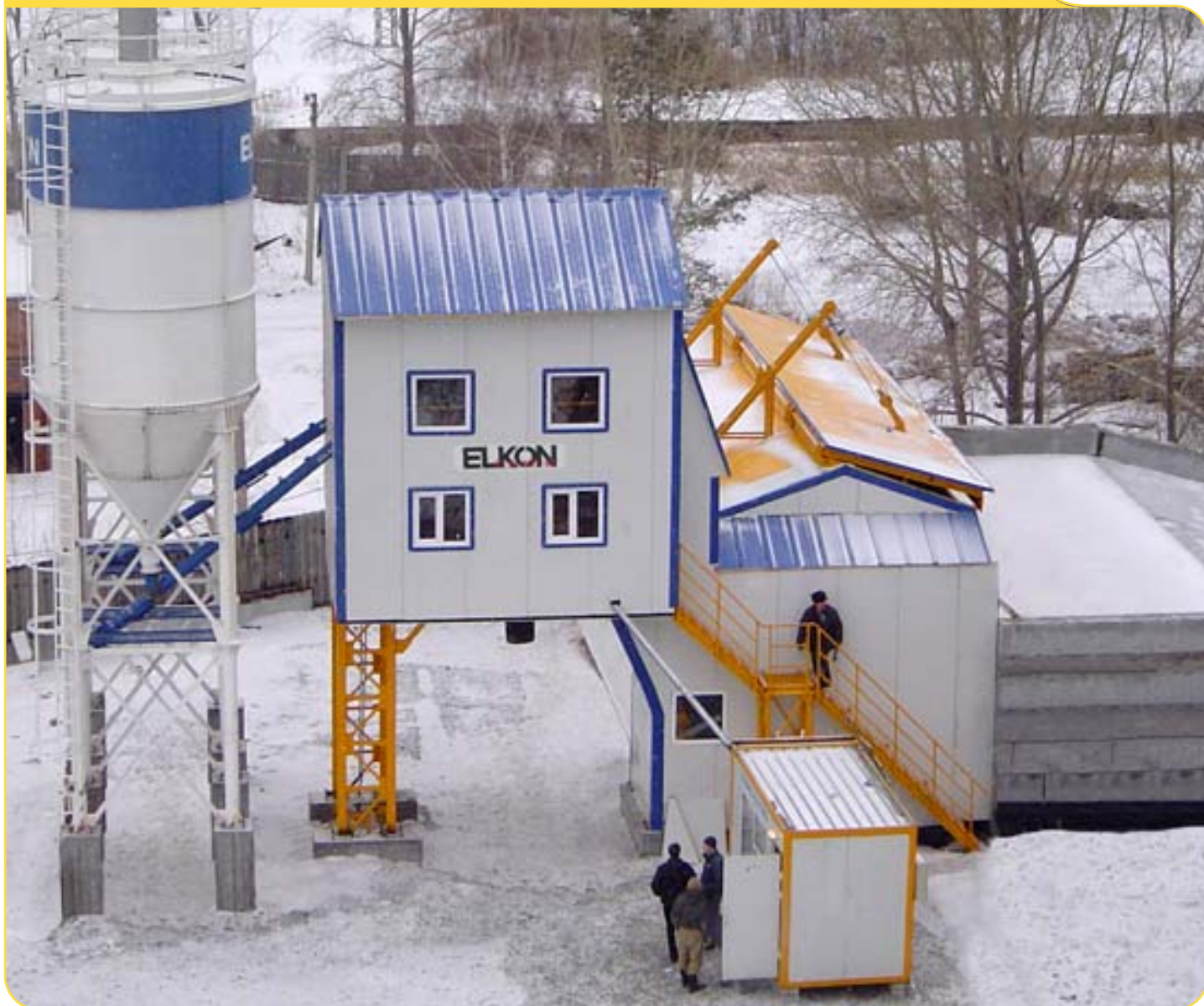
Общий вид бетонного завода ELKOMIX-60 всепогодного исполнения
